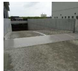
地下駐車場入口にある起伏式防潮板
