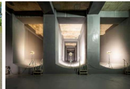
まちづくりにあわせた浸水対策施設の整備例(渋谷駅東口地下調整池)
