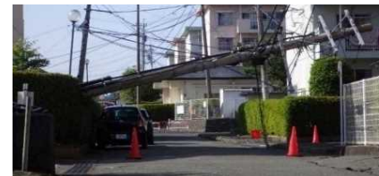
電柱の倒壊による道路閉塞の事例 （平成28年熊本地震）
