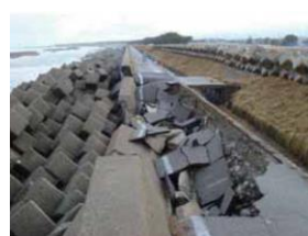
直立堤の倒壊状況（入善町五十里地区）
