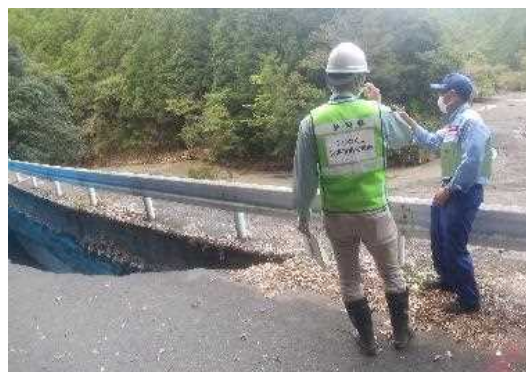
緊急調査状況(町道下泉河内川線)
