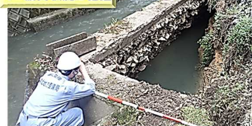
【R2.7月豪雨】 (熊本県錦町)
