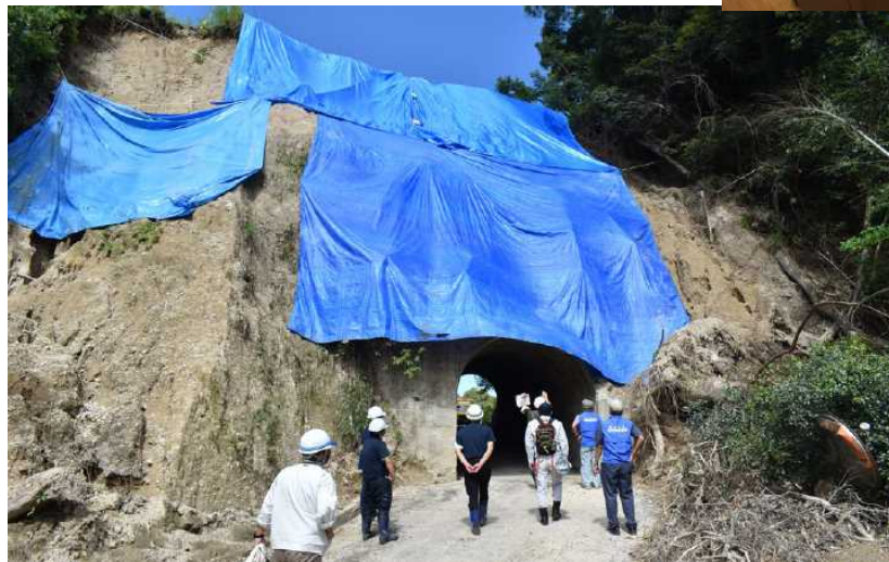
←被災状況の確認 (トンネルの被災)
