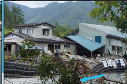
③右岸側の溢水被災状況
