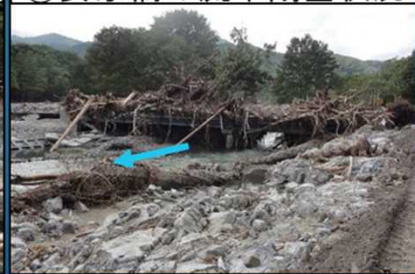
⑥安家橋の流木閉塞状況
