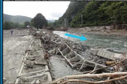
⑤右岸側の溢水被災状況
