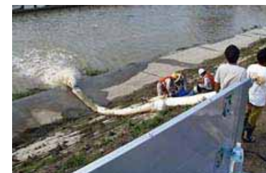
排水施設による排除状況
