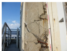
水門の門柱部のコンクリ剥離
