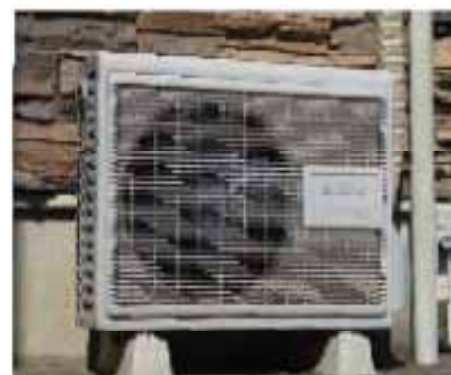
空気熱源ヒートポンプ
