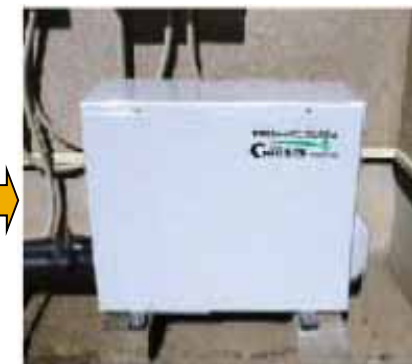
地下水熱ヒートポンプ
