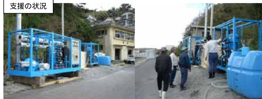
海水淡水化装置設置状況
