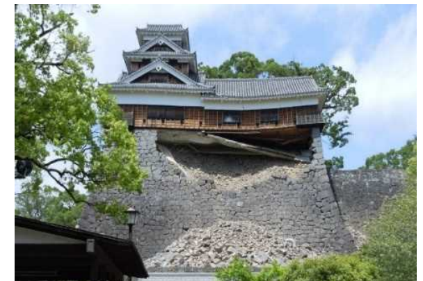
熊本城の被害
