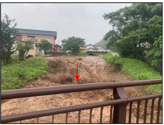
九頭竜川水系 暮見川 護岸損壊(勝山市郡町3丁目)
