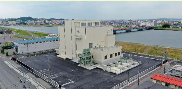
不動沢排水ポンプ場(R5. 3. 31より稼働)
