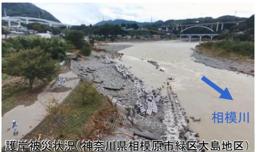
護岸被災状況(神奈川県相模原市緑区大島地区)
