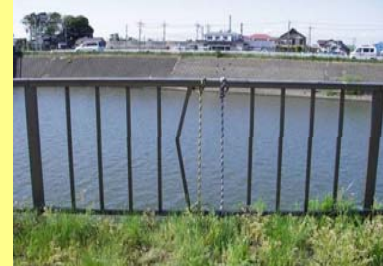
防護柵の損傷
