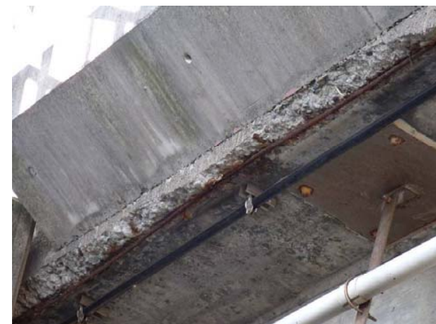
管理橋地覆部のコンクリ剥離、鉄筋露出状況
