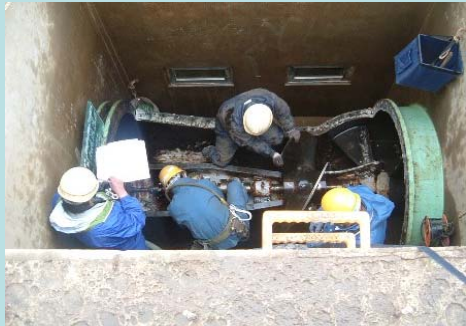
(ポンプ設備の点検・整備)
