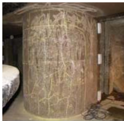
施設内水路に発生したクラック
