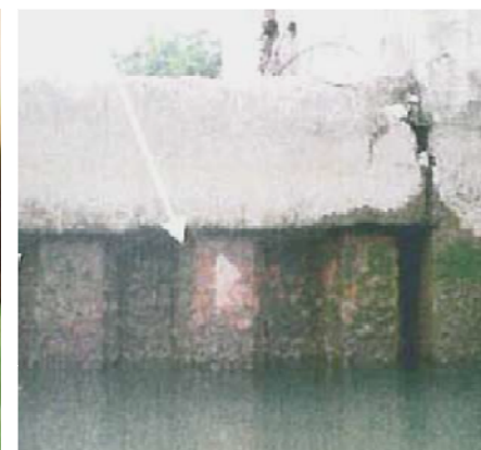
導水路の鋼矢板の腐食
