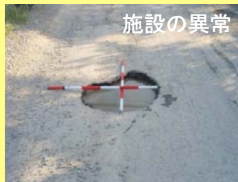
河川管理用道路に生じた陥没
