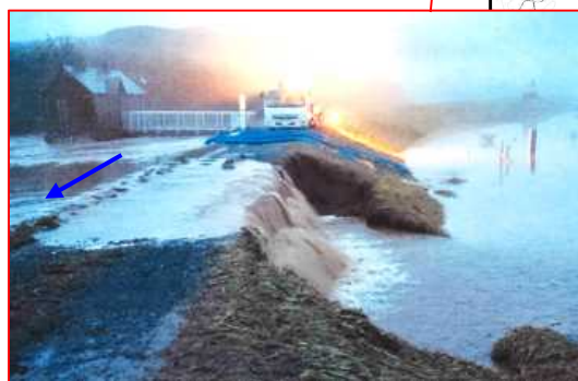
左岸22.6k 堤防裏法崩れ
