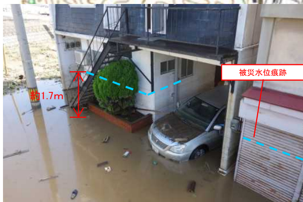
③ 床上浸水被害状況
