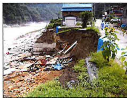
被災状況(金山町水沼地区)
