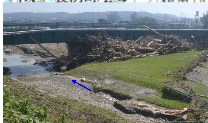
④ 橋梁の断面阻害状況（流木）
