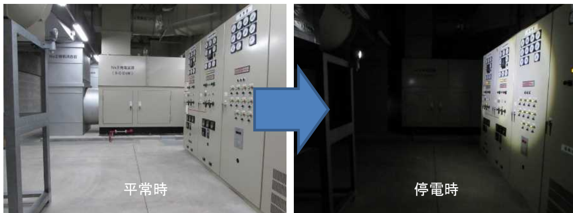
停電時の機械室の状況(イメージ)
