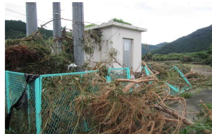
放流警報設備の浸水後の状況
