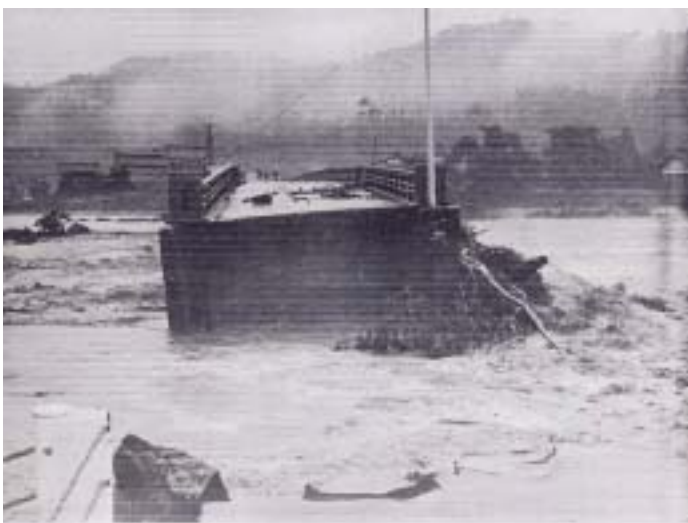
大石川流域川口橋の被害 出典：8.28 水害の関川 （関川村）
