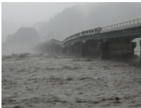
竜西橋陥没 (安倍川 19.5k 付近)
