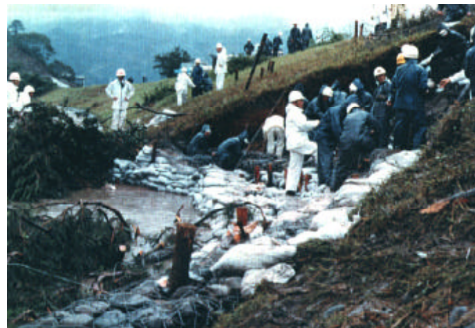
昭和57年8月洪水 (福田ヶ谷地先: 左岸12.0k付近)
