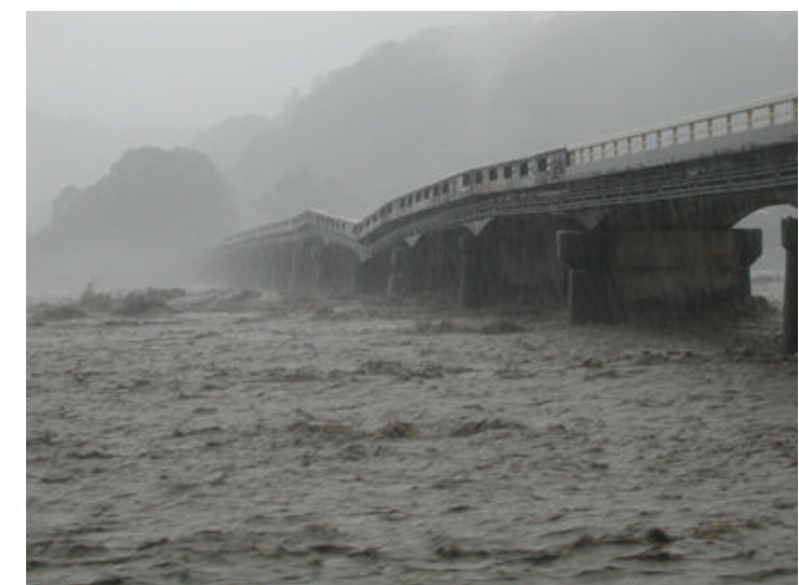
平成14年8月洪水 竜西橋 (19.5k付近) ・河床低下、洪水時の河床洗掘により橋梁が陥没
