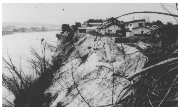
本荘市(尾花沢地区)の欠壊した河岸
