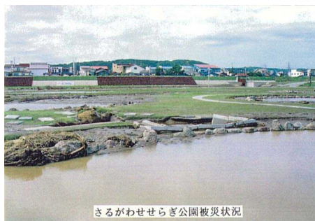
さるがわせせらぎ公園被災状況
