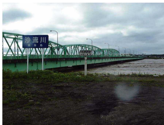
沙流川橋出水状況 写真出典：北海道開発局
