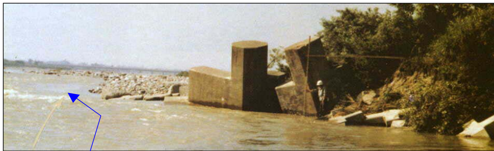
（上写真）河床の局所洗掘により巨大水制が傾く（立山町利他地先）
