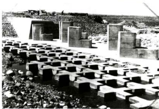
巨大水制群と根固工
