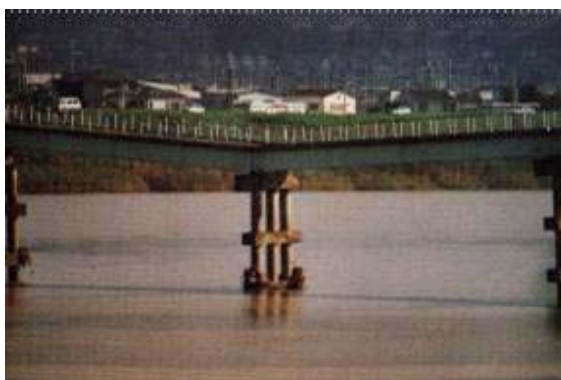
南海橋の陥没被害
