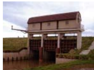
光ケーブル網・遠隔監視カメラで見た樋門（CCTV）
