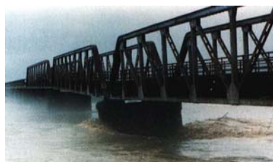
福井市高屋付近 高屋橋（県道福井三国線）の橋 脚が洗掘のため傾いた
