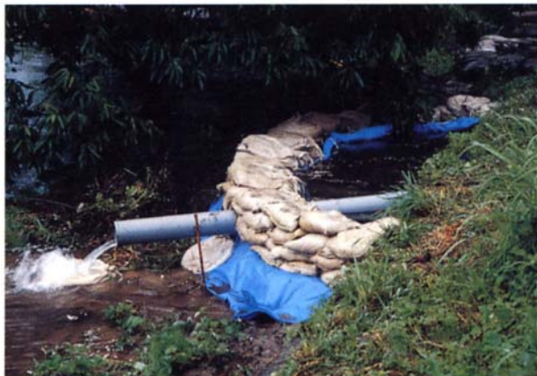
図-9.9 益田市安富地区の堤防漏水状況
