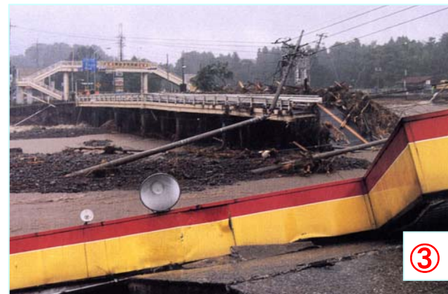
▲流出した余笹橋(国道4号)
