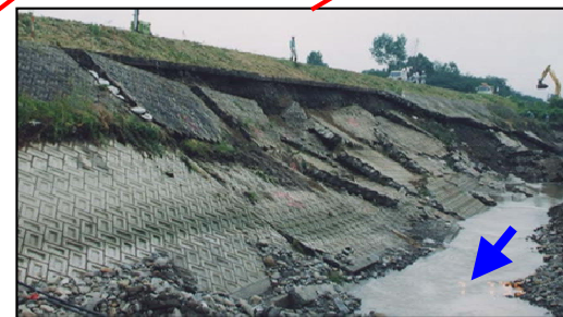
平成7年7月洪水での護岸崩壊(東温市牛淵地先)
