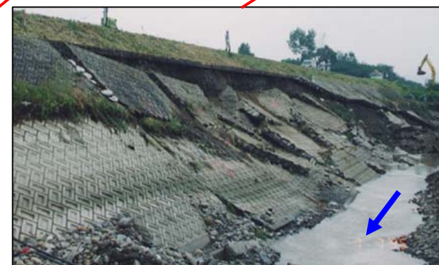
平成7年7月洪水での護岸崩壊(東温市牛淵地先)
