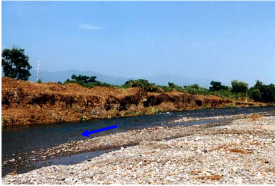
平成元年 8 月洪水での河岸崩壊 (松山市南高井地先 みなみたかい )
