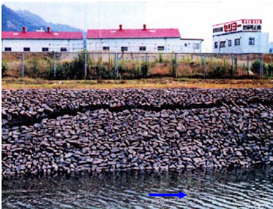
平成 8 年 7 月洪水での護岸崩壊 (砥部町八倉地先 やくら )
