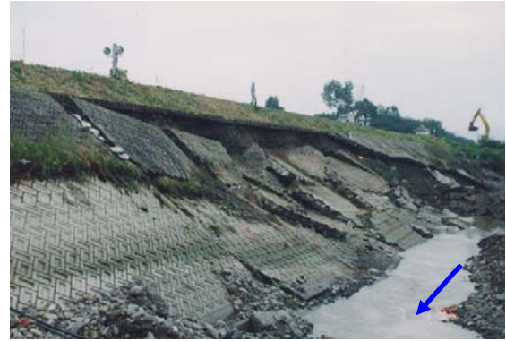
平成 7 年 7 月洪水での護岸崩壊 (東温市牛湫地先 うしぶち )
