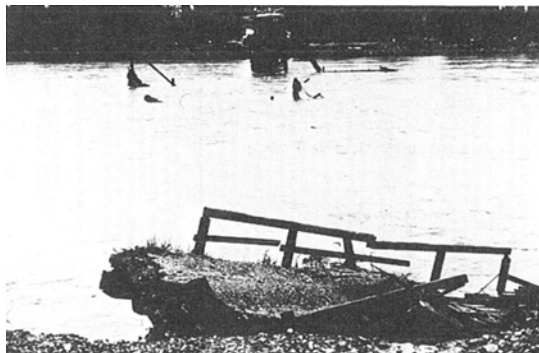
流失した大正橋 昭和 46 年 8 月洪水
