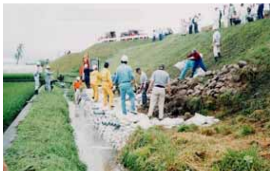
漏水による水防活動状況
