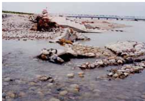
河岸侵食等により被災した護岸
