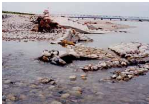
河岸侵食等により被災した護岸
