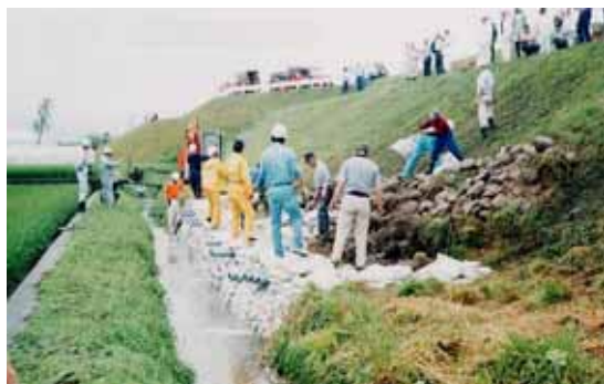
漏水による水防活動状況
