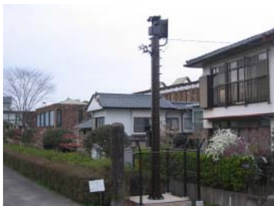
【人吉市街部の CCTV 施設】
