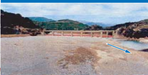
② 枯渇した塩郷堰堤下流の状況
