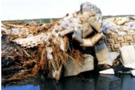
S57.8洪水時の護岸被災状況
