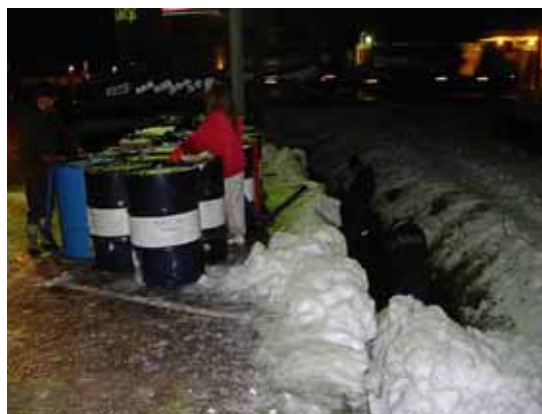
流出油汲み取り作業状況
