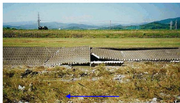
平成10年9月洪水での統合堰下流の低水護岸の被災 (香美市山田地先)
