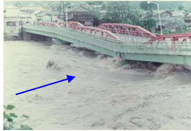
○昭和47年7月洪水 深淵流量：約4,400m³/s(戦後第2位) かがみばし 香我美橋の橋脚の被災
