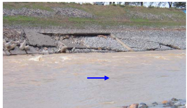
堤防護岸欠壊及び根固流出
