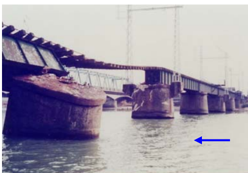
落橋した加越能鉄道橋
