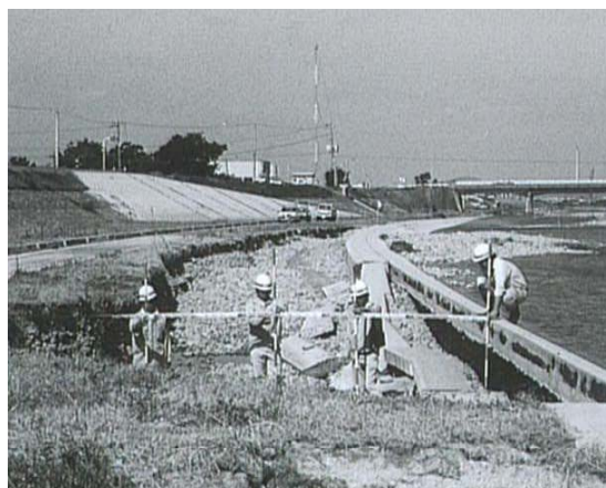
河岸被災状況
