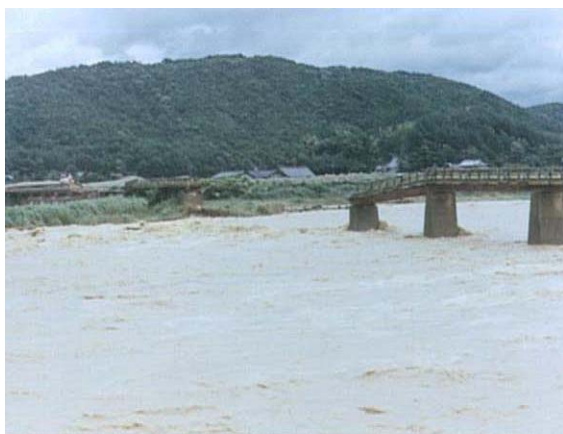
旧乙井橋(11.6k付近)流出
