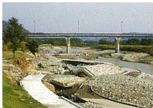
長尾護岸崩壊(平成16年10月台風23号洪水)
