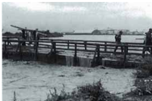
昭和 44 年(1969)8 月出水の早出川被災状況
