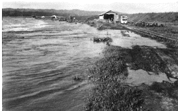
鵠川左岸宮戸築堤工事に使用している土運車流失する
