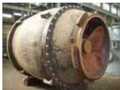
老朽化した排水ポンプ （糸貫川天王川排水機場）
