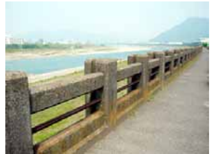
忠節の特殊堤 長良川 51k 付近 《提供：岐阜市》
