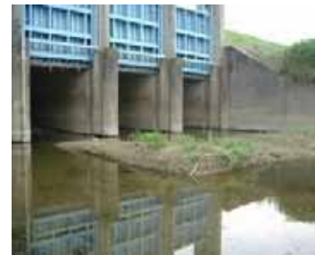
樋管吐出口の推砂状況
