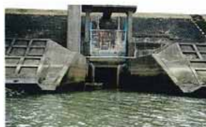
老朽化した樋管
