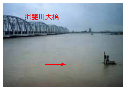
桁下高不足の橋梁の洪水時の状況
