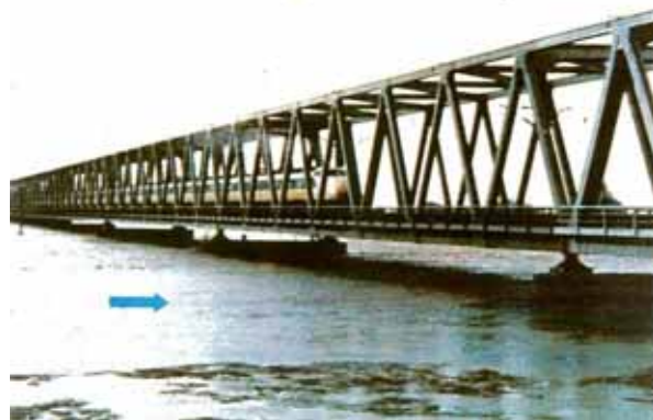
新幹線揖斐川橋の状況
