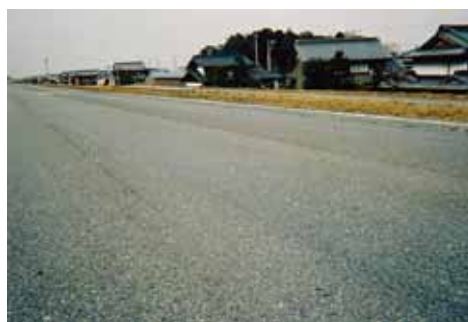
堤防天端のわだち（揖斐川 17.4k 左岸）
