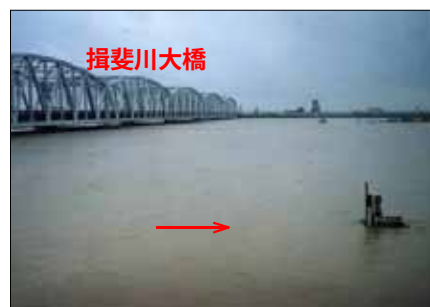
桁下高不足の橋梁の洪水時の状況
