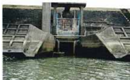
老朽化した樋管
