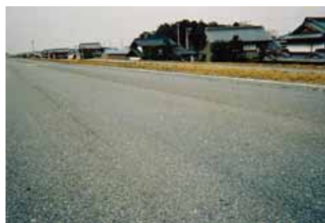
堤防天端のわだち (揖斐川 17.4k 左岸)
