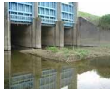
樋管吐出口の推砂状況
