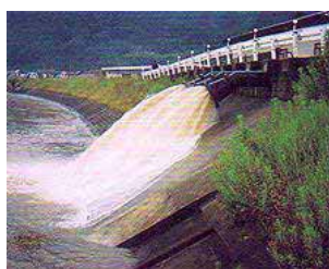
畠敷排水機場運転状況 (H10.10 出水時)
