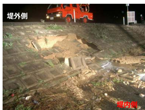
岡山県管理 海岸堤防被災状況
