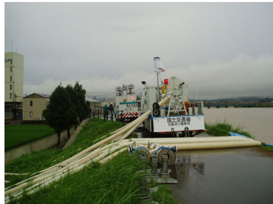
川田川樋管排水ポンプ車
