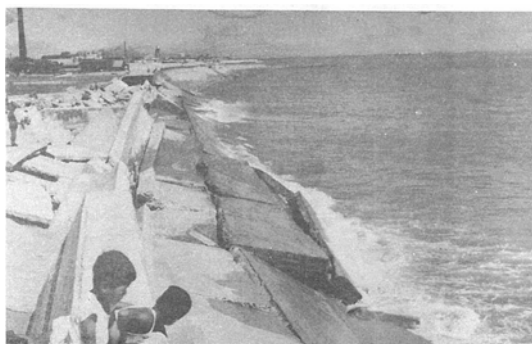
海岸堤防の決壊（磯津海岸）
